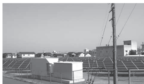
網野に設置された市民太陽光発電所
