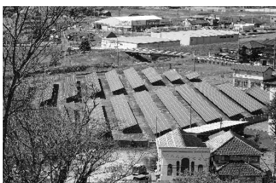
市の太陽光発電設備
