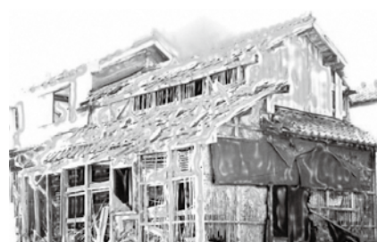
管理不全で廃屋化している空き家
