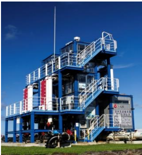
沖縄県 海洋温度差発電実証試験設備(出典:沖縄県HP)
