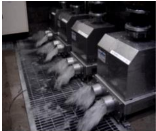
美山町「芦生の森」 マイクロ水力発電設備 (出典:京都府HP)
