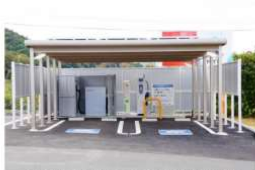
電気自動車用充電ステーションを市内7箇所に整備 ※太陽光発電設備と蓄電池を併設し、非常用電源ステーションとしても利用可能。
