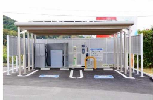
電気自動車用充電ステーションを市内7箇所に整備 ※太陽光発電設備と蓄電池を併設し、非常用電源ステーションとしても利用可能。
