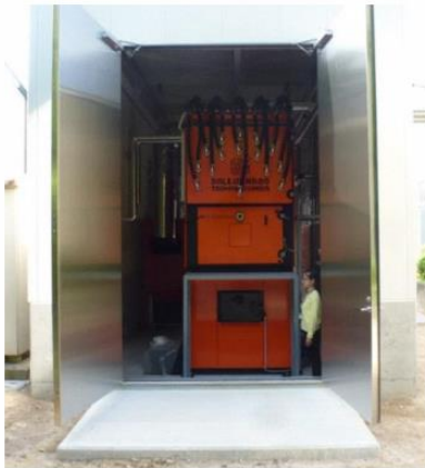
温泉施設に木質バイオマスボイラーを導入
