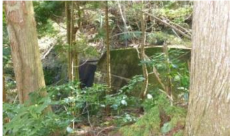
土砂流失を防ぐ砂防ダム
