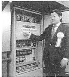
市内第1号のチップボイラーが波多温泉・満寿の湯で稼働
