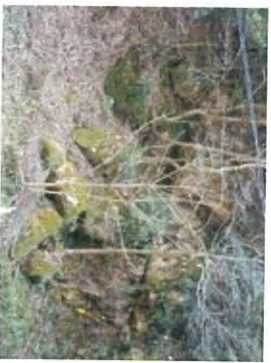
写真 道路沿い斜面の状況(落石発生源)
