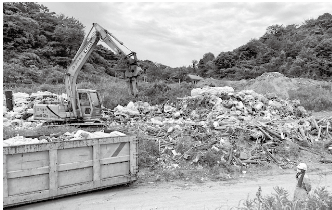
最終処分場の現状
