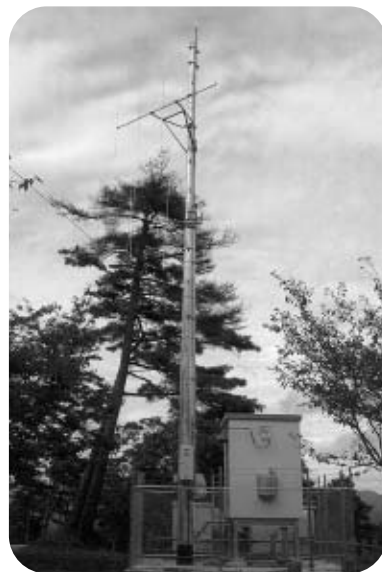
平成20年度運用開始 防災行政無線基地アンテナ
