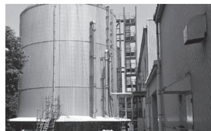
漏出したメタン発酵タンク
