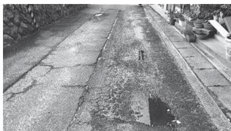
久僧中浜上道線、修繕が待たれる一例です
