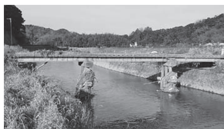
撤去が急がれる川向橋
