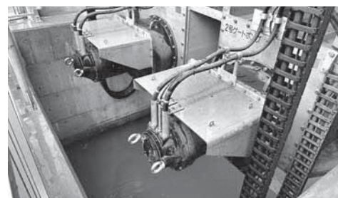
完成した小栓川雨水ポンプ場
