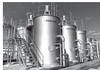
整備が進む中野浄水場
