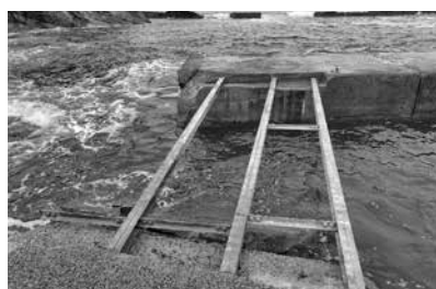
漁港の落下した橋
