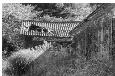
除却が求められる旧五箇小学校成路分校
