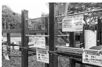
修繕されないままの公園遊具
