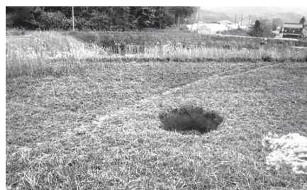
コルゲート管老朽化により陥没した国営農地
