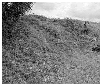
改修が急がれる墳丘へ登る崩れた階段
