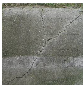
斜め方向のひび割れ
