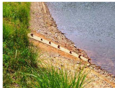
老朽化した取水施設
