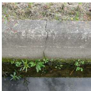
縦方向のひび割れ
