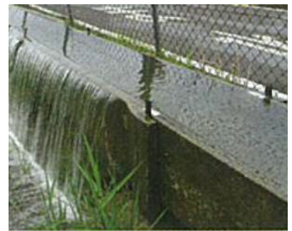
水路からの溢水
