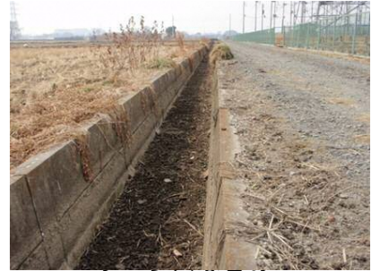
安全施設がない水路
