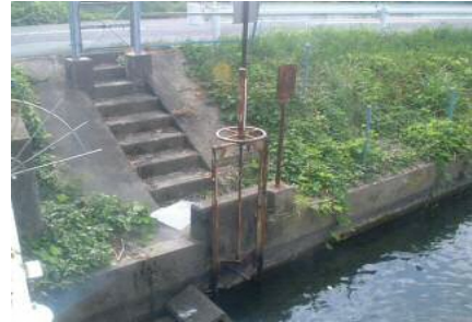
老朽化したゲート
