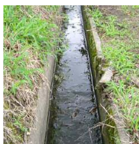
部分的な欠損
