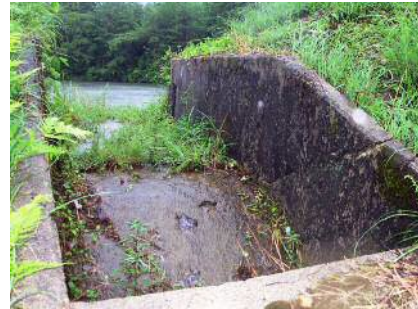
老朽化した洪水吐
