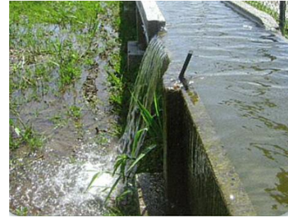
水路からの部分的な溢水
