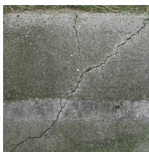
斜め方向のひび割れ
