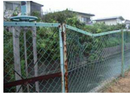
破損した金網フェンス
