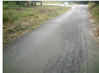
アスファルト舗装の 老朽化
