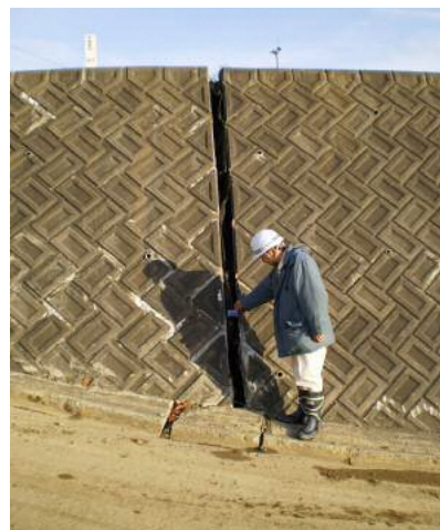
ブロック積みの隙間
