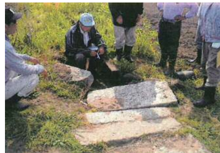
側溝蓋の損傷
