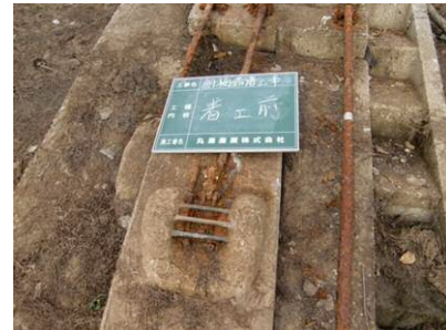
ため池における 老朽化したゲート
