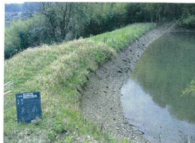
漏水が生じているため池
