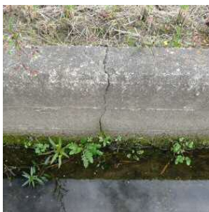
縦方向のひび割れ
