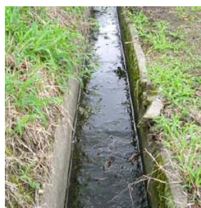
部分的な欠損
