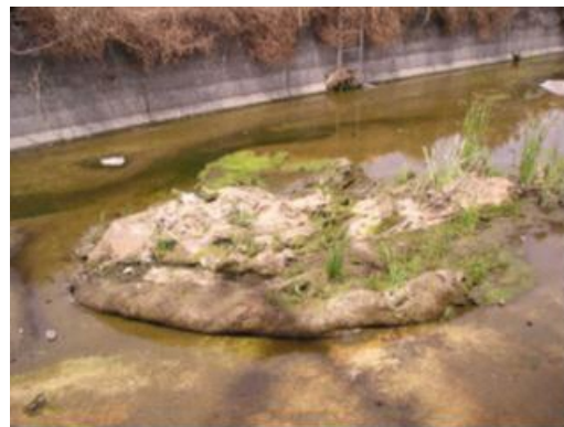
土砂の堆積状況
