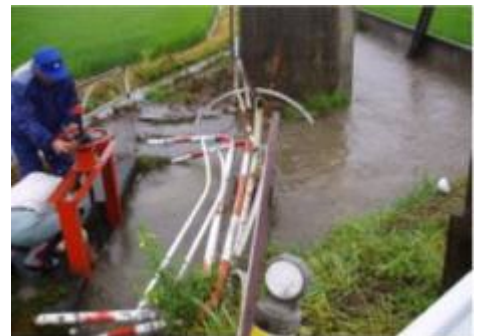
ゲートへのごみや流木の流入状況
