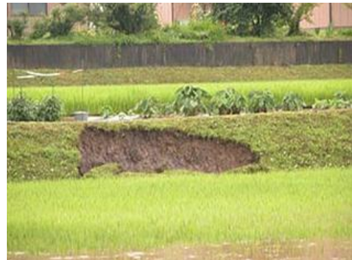
法面の崩壊状況
