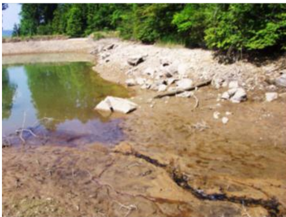
ため池に流入した土砂
