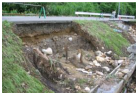
道路法面の崩壊状況
