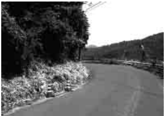
カラーコーンで危険個所が示されている市道西本町・河梨線。当面は定期的な監視を行う予定
