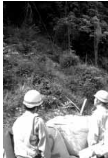
昨年10月の台風23号により、土砂崩れが起きた、久美浜町河梨の民家裏の急傾斜地を入念に点検
