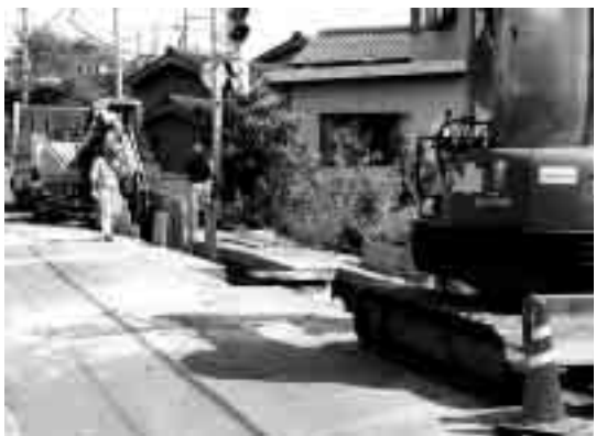
市内で順次整備が進められている下水道。供用開始後は、早期接続をお願いします（写真は峰山町荒山地内）
