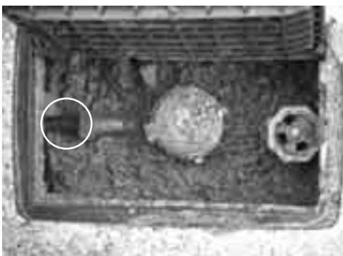
白丸で囲ってある部分が宅内へ伸びる給水管。管の色がグレーや黒であれば非鉛管
