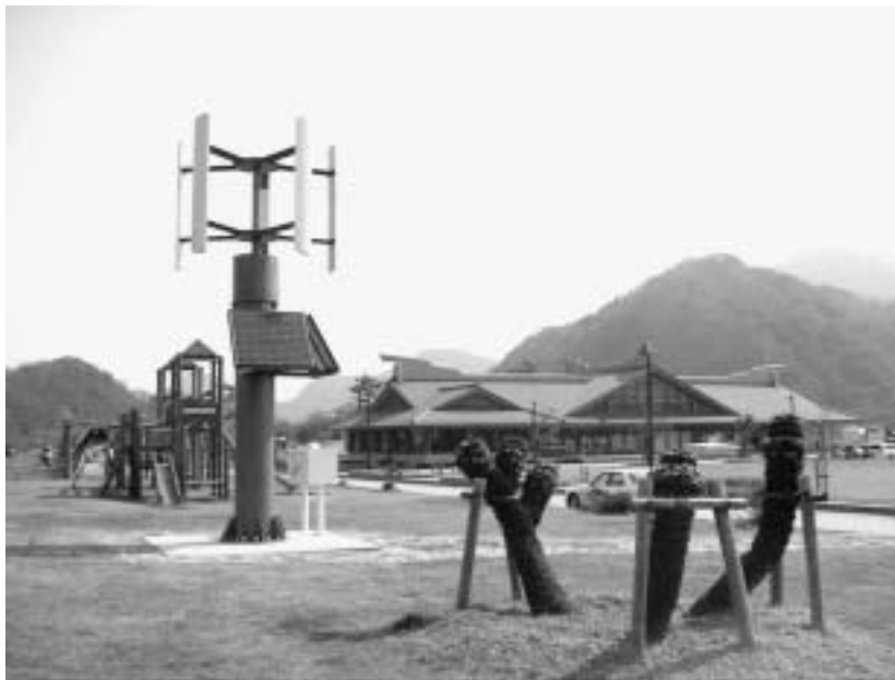
「道の駅てんきてんき丹後」に設置した小型風力発電機
