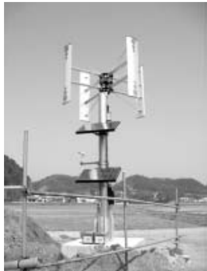
農作業場に建てられた小型風力発電機
