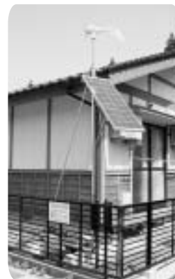
老人福祉施設に設置された小型風力発電機
