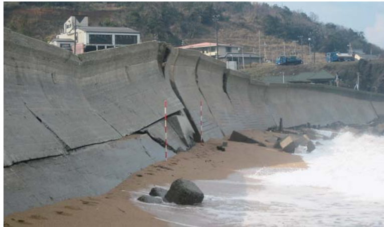
平成19年1月、冬季風浪により破堤（被災直後の後ヶ浜護岸・丹後町間人）
