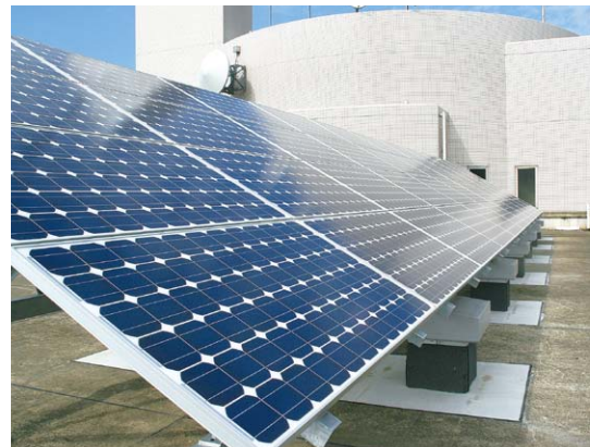
峰山庁舎屋上に設置したソーラーパネル
