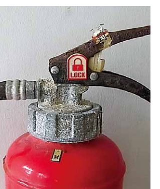
▲レバーがさび、ふたが腐食している
