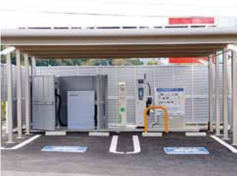
くみはま SANKAIKAN に設置された災害時対応型の充電ステーション
