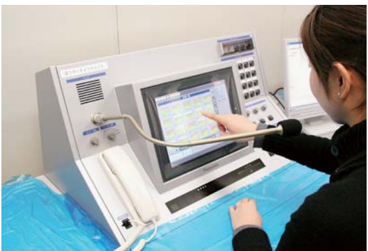
デジタル防災行政無線の録音システム
