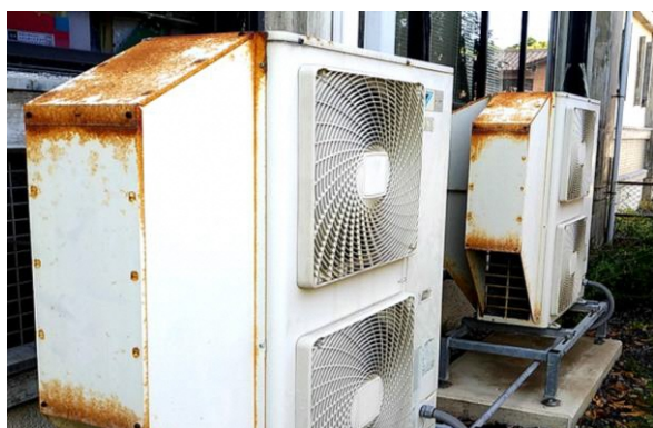
峰山総合福祉センター(空調設備)
