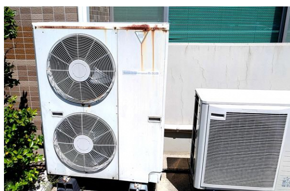
大宮庁舎(空調設備)
