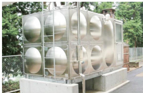
災害時に備えた受水槽容量(4日分)を確保
