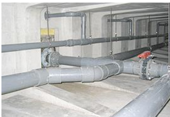
将来の設備更新に対応できるように、床下に設備専用のスペースを設置
