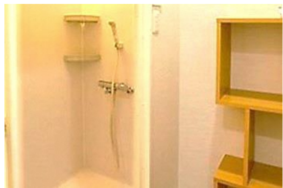
24時間体制での活動を支えるための仮眠室やシャワー室を設置
