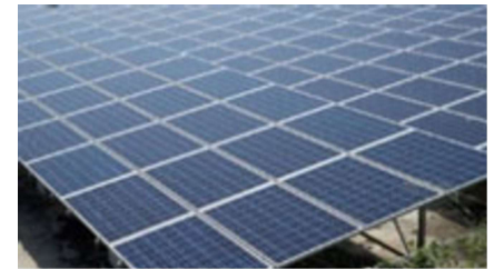
④ 太陽光発電パネル
