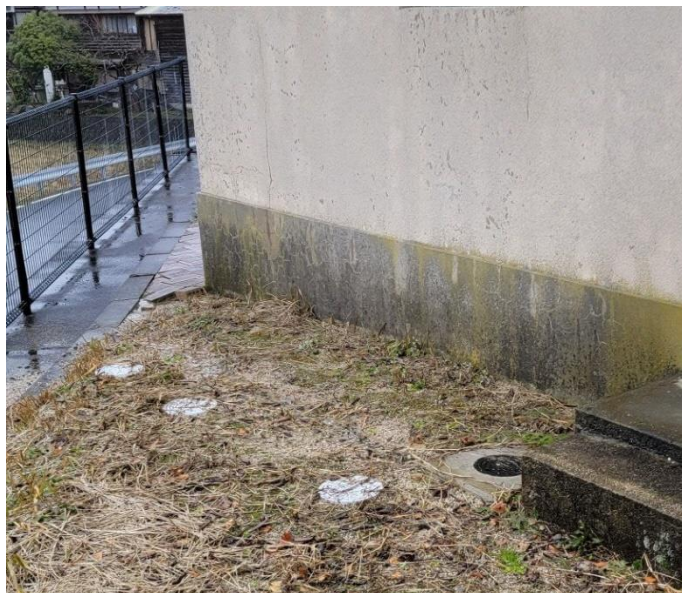
トイレ裏の軽荷重排水枡
