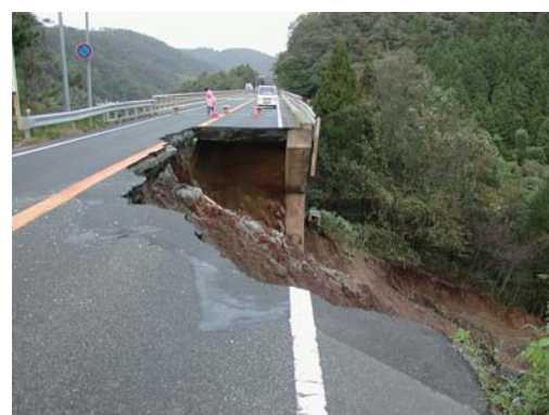
平成16年台風第23号での被害
