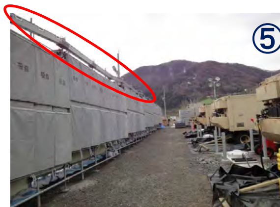
減音装置(③上部) (26. 12. 24設置)
