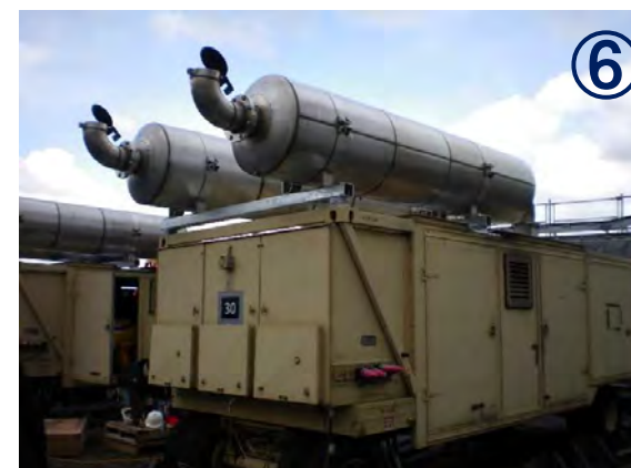
発電機マフラー
