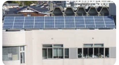
市役所峰山庁舎屋上の太陽光パネル
