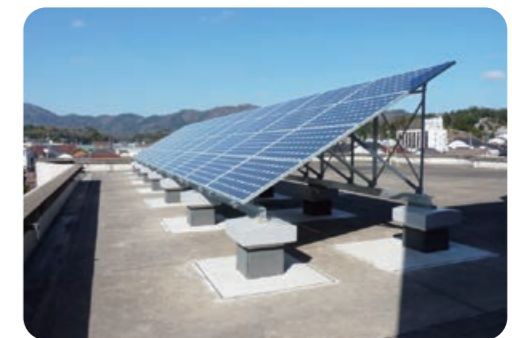
峰山庁舎に設置した太陽光発電設備
