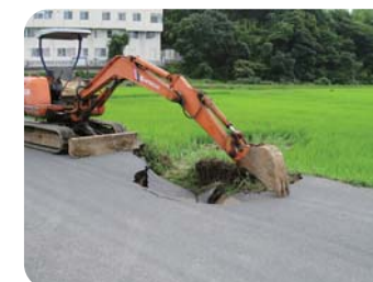
石綿管による用水管パイプラインの破損
