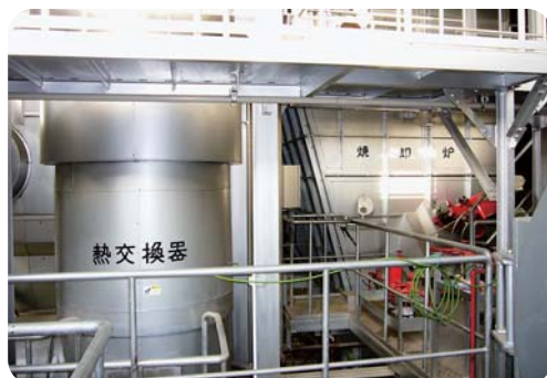
竹野川衛生センター熱交換器
