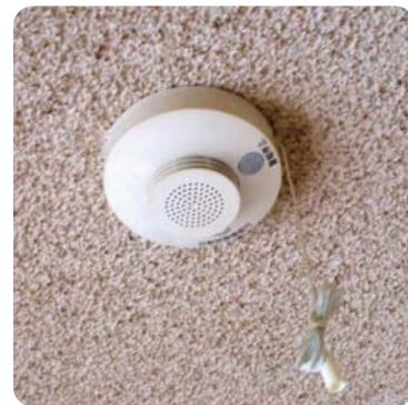
天井などに取り付けられる火災報知器
