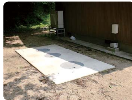
公民館に設置した浄化槽
