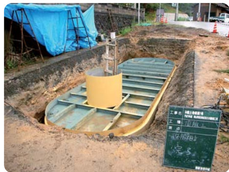
峰山町新治地区に設置された防火水槽
