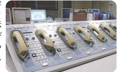
消防本部通信指令室
