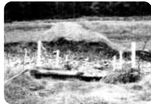
台風23号により 崩れ落ちた農道 橋(久美浜町)
