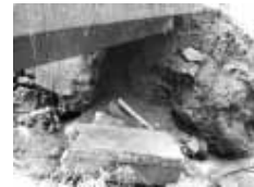
橋りょう災害
